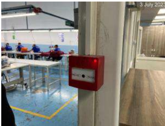
Fire Alarm Button.jpg
