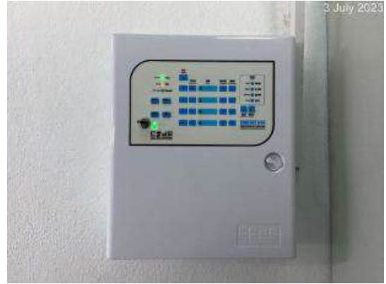
Fire Alarm Panel.jpg
